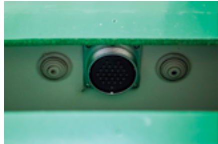
Рис. 8. Вид снизу основания шкафа управления.
